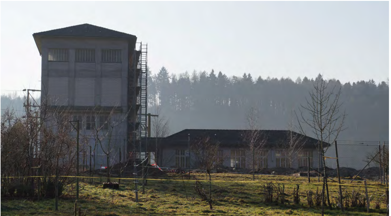
Die BKW bricht den Turm Unterstation an der Bürenstrasse 20 ab sowie das Nebengebäude 21b. Die Gebäude sind für die heutige Stromversorgung nicht mehr notwendig.
