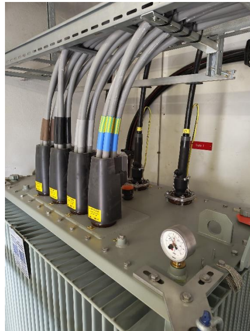
Berührungssichere Anschlüsse einer Sanierten Trafostation
