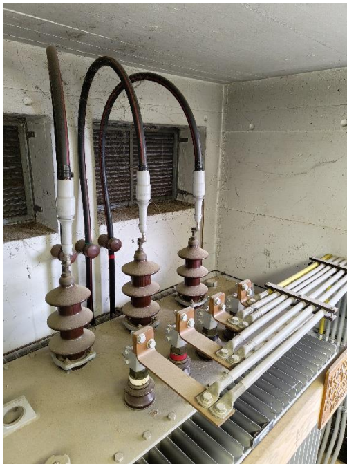
Nicht Berührungssichere Anschlüsse TS Schlössli 400 Volt vorne und 16'000 Volt hinten
